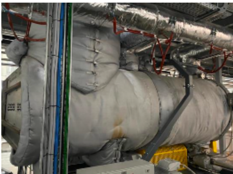
Figura 11: reattore di decontaminazione.
