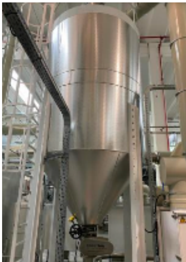
Figura 13: silo di raffreddamento.
